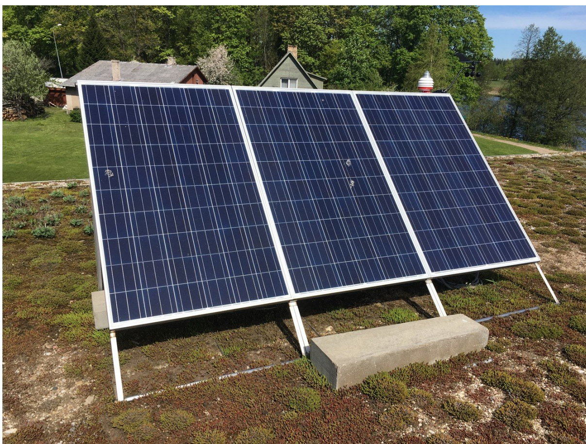
2.11. att. Fotovoltāžas panelis.
